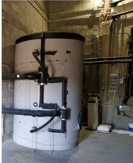
Fotografía 21. Depósito inercia. Red de calor Portell de Morella.
