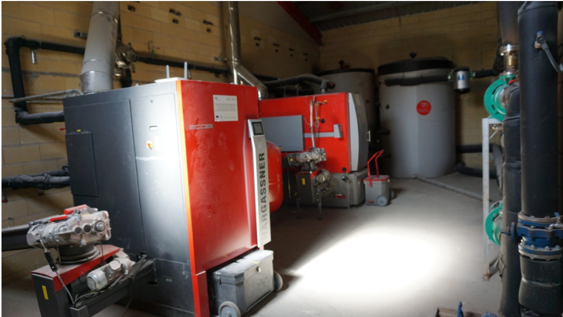
Fotografía 2. Central de generación de calor de la red de calor de Todolella.
