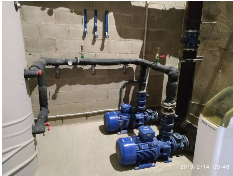
Fotografía 22. Equipo de bombeo. Red de calor Portell de Morella
