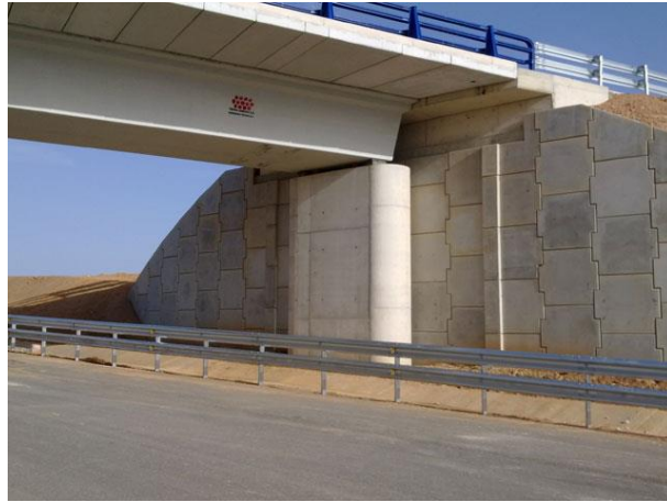
Figura.- Estribo a base de escamas prefabricadas. Puente resuelto además con viga artesa y prelomas prefabricadas
