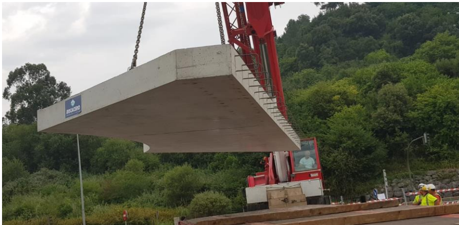
Figura.- Puente de La Baskonia en Basauri, estructura mixta con prelosas de hormigón armado. Piezas de esquina, en cuchillo y rectas componen este complicado puzzle que encaja a la perfección.
