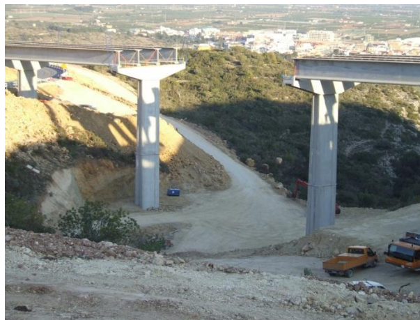
Figura.- Estructura de puente mediante varios elementos prefabricados de hormigón: pilas, dinteles y vigas I
