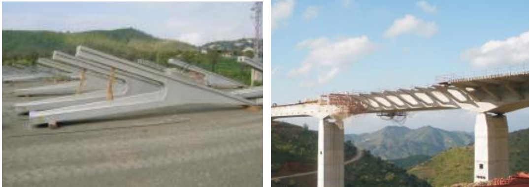
Figuras.- Los jabalcones son elementos singulares de gran calidad estética que permiten aumentar la anchura efectiva, trasladando las cargas laterales al núcleo del tablero
